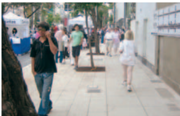
Rua Oscar Freire/SP – Placas de concreto.
