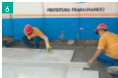
6 Conferência de nível, aplicação de argamassa de rejuntamento, limpeza e abertura ao tráfego.
